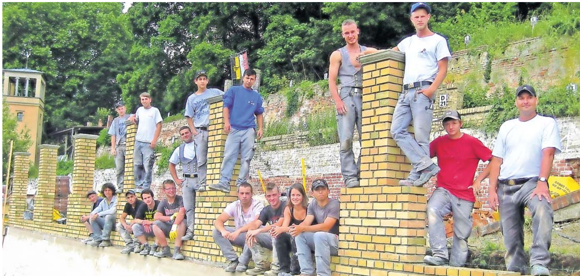
Richtig rangeklotzt: 18 Lehrlinge aus Pforzheim bauten in zehn Tagen eine ganze Terrasse am Potsdamer Winzerberg wieder auf.
